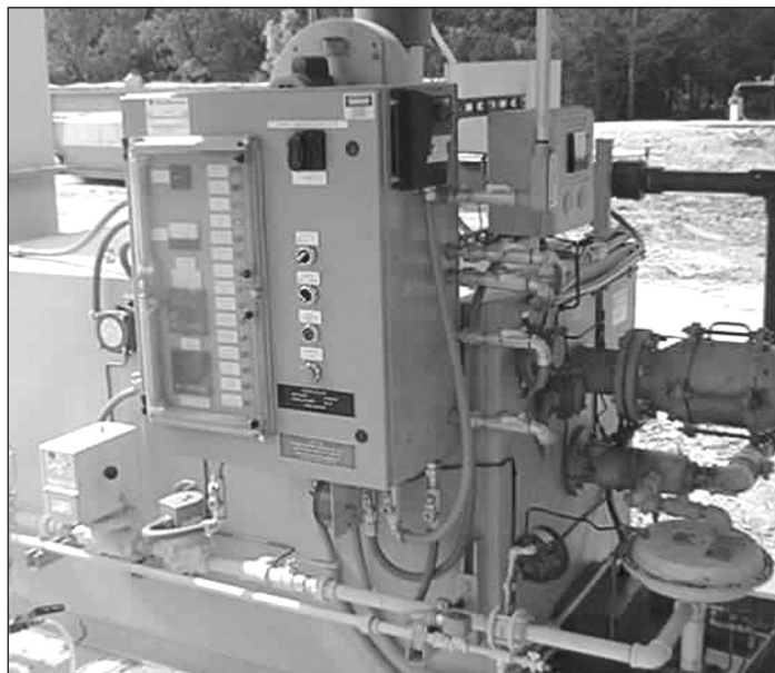
Figura 10. Equipo de extracción al vacío para realizar Bioventing (Fuente: Applied Hydrology Associates Inc, 2004)
