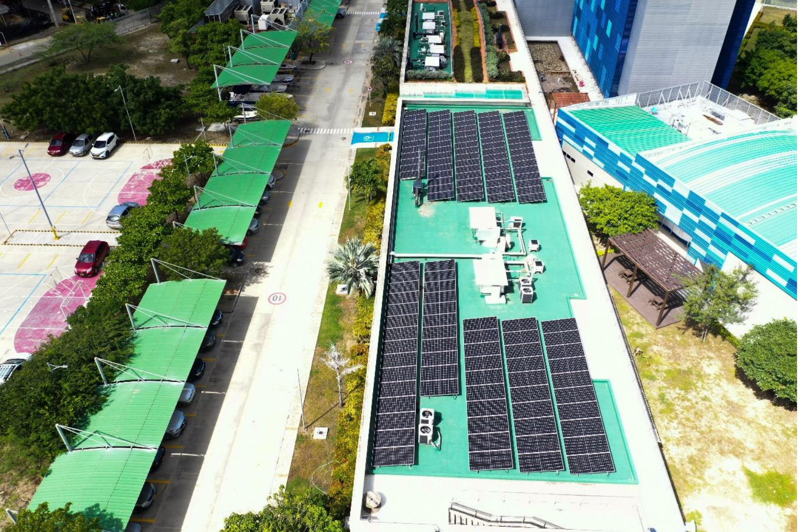
Figura 2. Batería de paneles solares instalados en la sede principal de INVEMAR, en Playa Salguero, Santa Marta.
