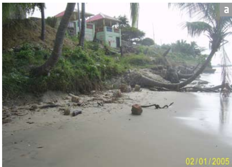
Figura 6.48. a y b) Acantilados en la población de Remedios donde se observa parte de la infraestructura urbana muy cerca del talud y afectada por la acción del mar (fotos Programa GEO-INVEMAR).
