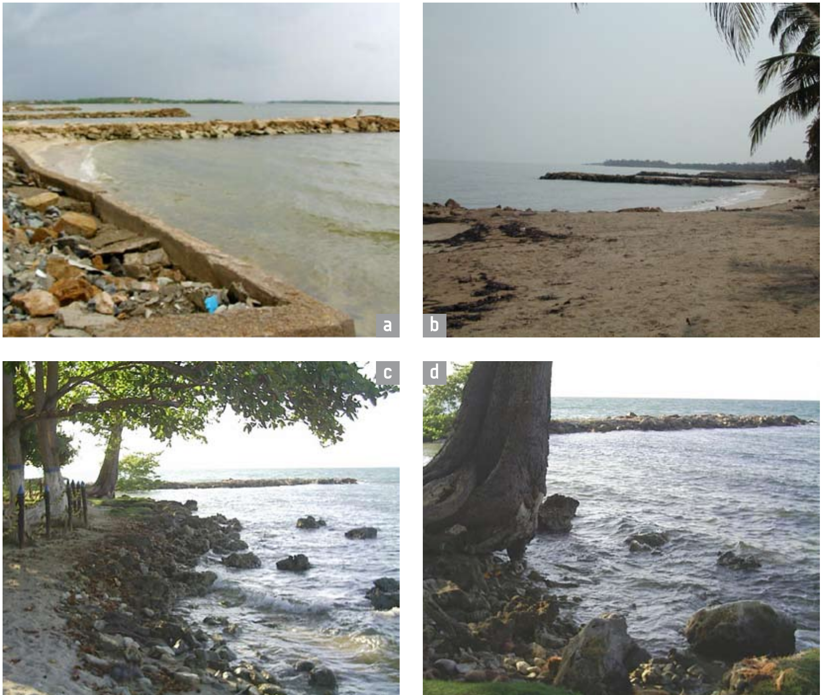
Figura 6.33. a y b) Espolones y estructuras semidestruidas en Playa Blanca, Cispatá (fotos Alcaldía San Antero e INVEMAR); c y d) Playas del Porvenir, en San Antero, protegidas con cantos y bloques en el escarpes de playa, y árboles desarraigados en la zona intermareal (fotos Alcaldía San Antero).
